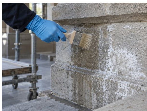
Traitement de dépôts salins sur parement.
