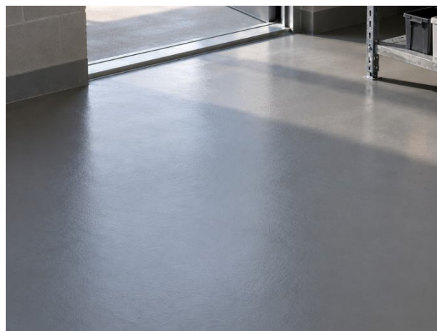
Finition alkyde-uréthane d'un sol béton compatible.
