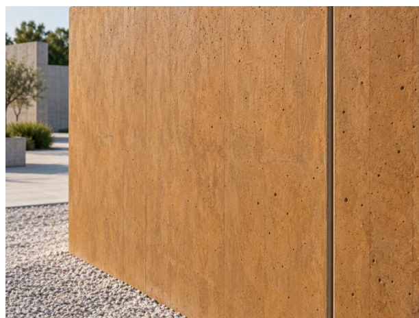
Lasure semi-transparente sur un mur architectonique en béton.
